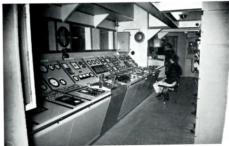
Controlekamer aan boord van het m.s. „Daphne”
